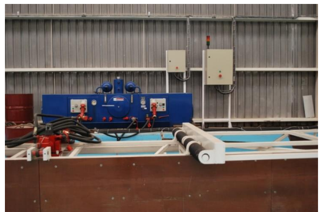
Generador Hidráulico de olas tipo pistón con unidad hidráulica
